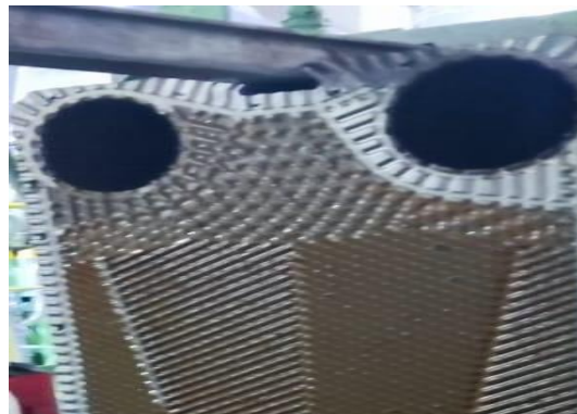
Gambar 3. Kerusakan gasket Sumber : Dokumentasi penelitian
